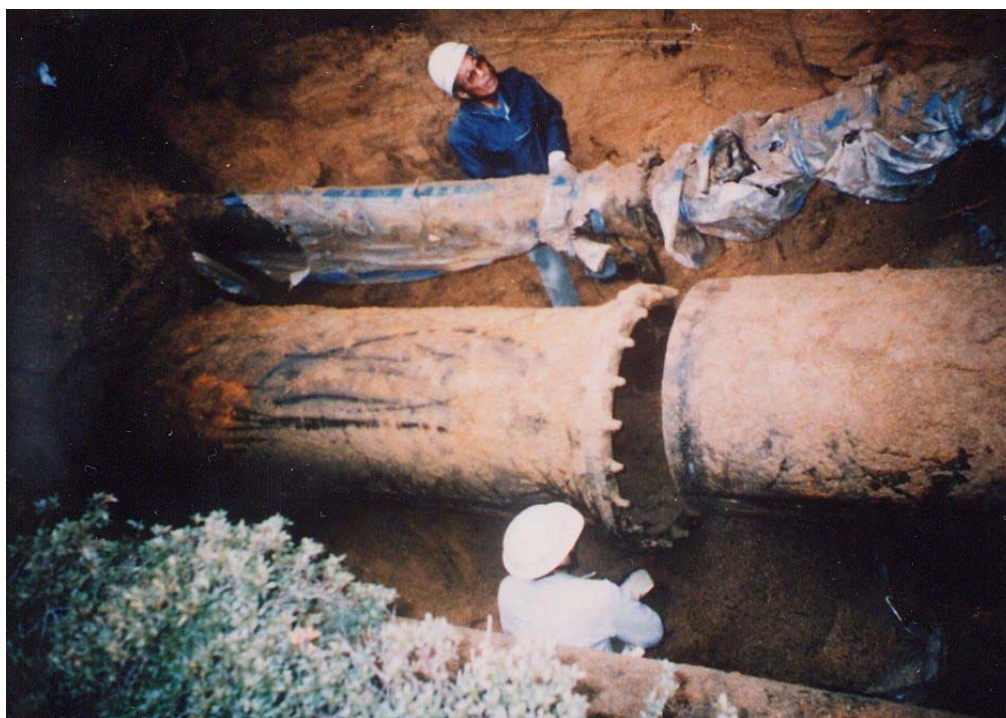
写真 9 大口径管 継手離脱状況（市役所前φ800） 兵庫県南部地震 （提供）神戸市水道局
