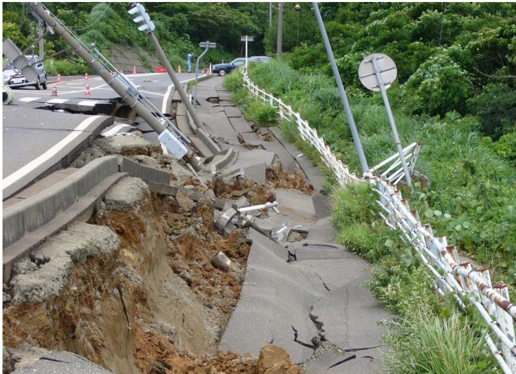
写真 14 盛土部の斜面崩壊状況〔鯨波 1 丁目乙 1509 番地先〕 新潟県中越沖地震 （出典）平成 19 年（2007 年）新潟県中越沖地震水道施設被害等調査団（厚生労働省健康局水道課）、平成 19 年（2007 年）新潟県中越沖地震水道施設被害等調査報告
