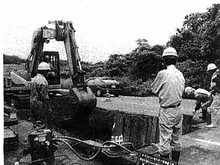
被害を受けた導水管の取替工事 (17日午前、柏崎市赤坂町地内)
