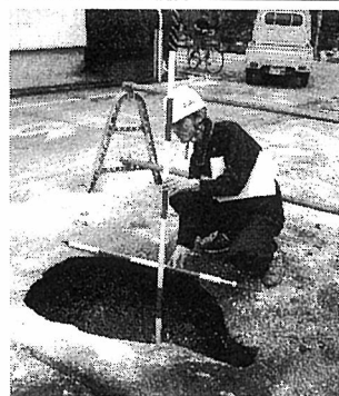
柏崎市内の圧送管破損箇所(写真提供=国土技術政策総合研究所)
