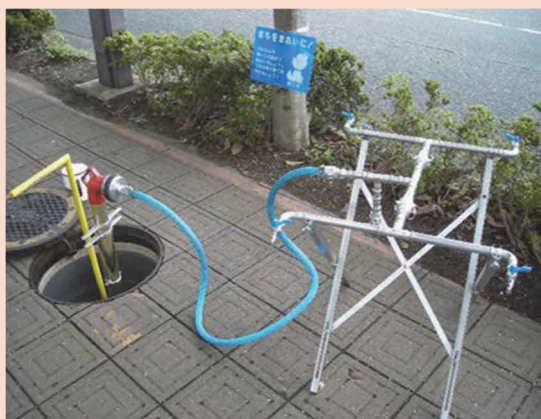
消火栓からの仮設給水栓
