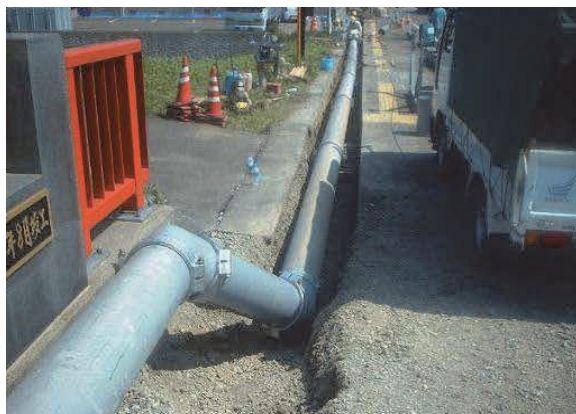
仮設配管(ステンレス管)
