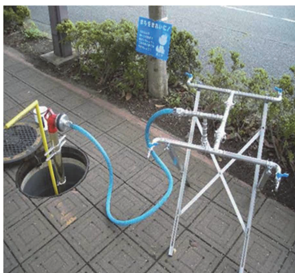
消火栓からの応急給水①
