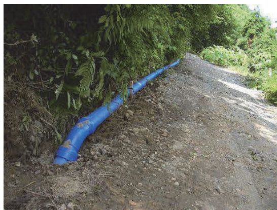
仮設配管(ポリエチレン管)
