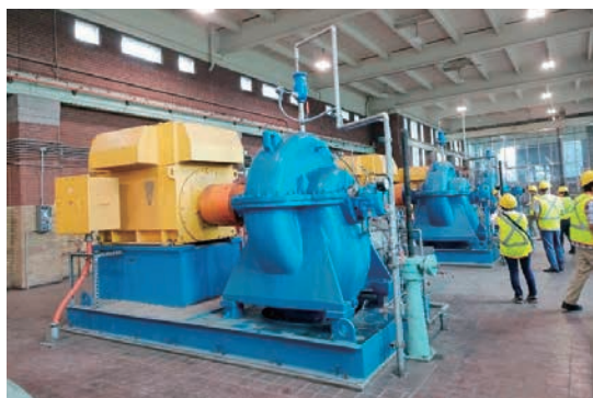
Woodward 浄水場における送水ポンプ
