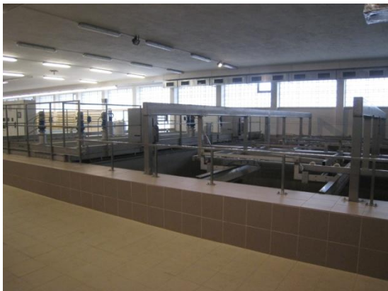
<加圧浮上法による凝集池（全景）>
