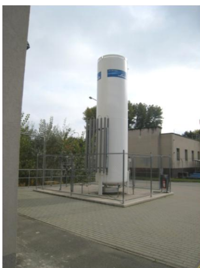
<液体酸素の保管設備>
