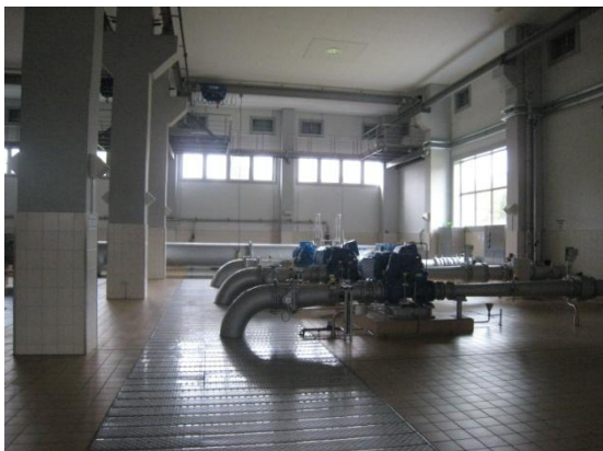
<配水ポンプ設備>
