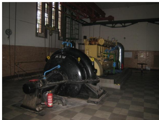
<地下水取水用のポンプ設備>
