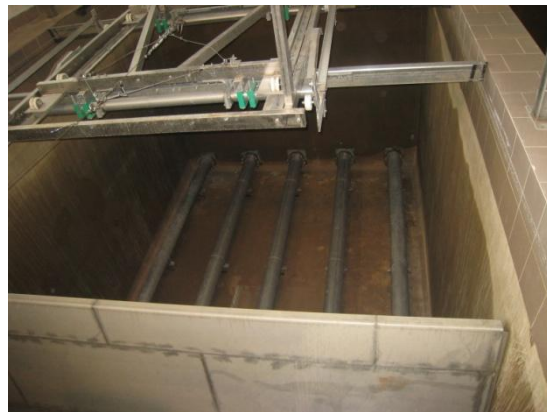
<加圧浮上法による凝集池（池内）>
